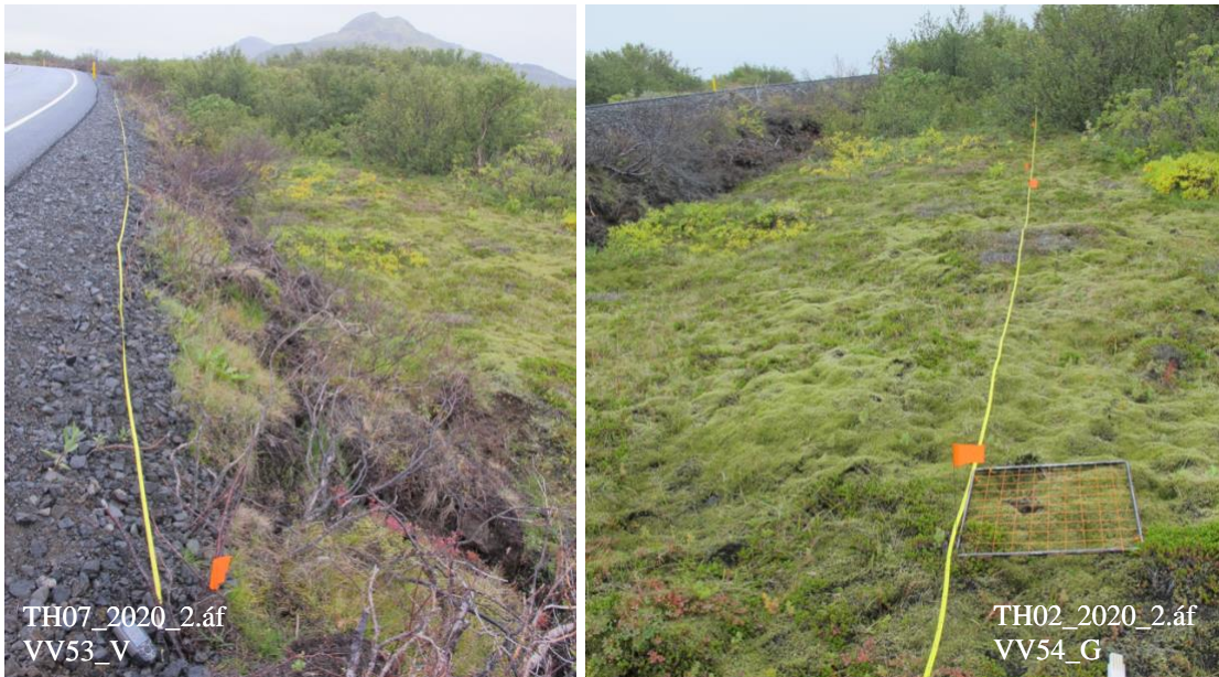
Mynd 6. Ásýnd vegfláa (vinstri) samanborið við aðliggjandi grenndargróður (hægri) í öðrum framkvæmdaráfanga. Myndirnar eru teknar í ágúst 2020, ári eftir flutning á gróðurtorfum í vegfláann.
